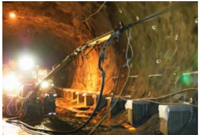
Allt berg sprutas in med fiberarmerad betong och 4 meter långa bultar borras in i berget. I bildens underkant syns några av de 1 300 platsgjutna betongplintarna (höst 2004).
