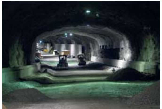
En trolsk vy över arbetena i bergtunneln som de såg ut hösten 2004.
