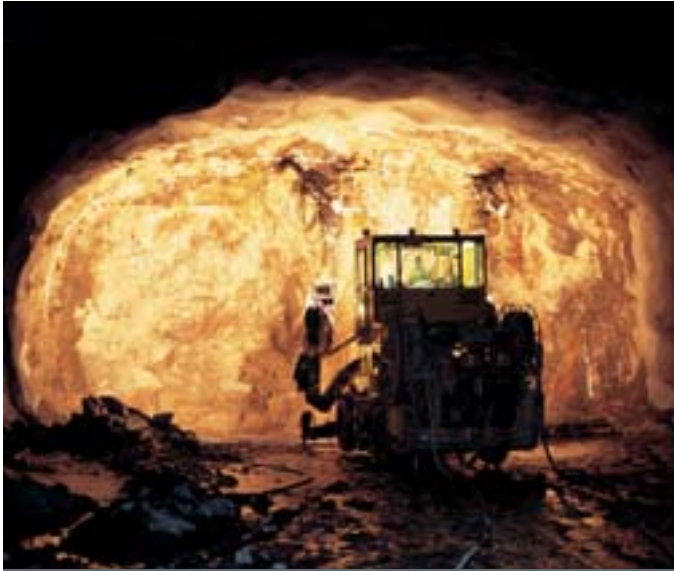
Borrhiggarna var eldrivna för att ge bättre arbetsmiljö. Sprängningarna skedde med stor försiktighet för att påverka omgivningen så lite som möjligt (vår 2002).
