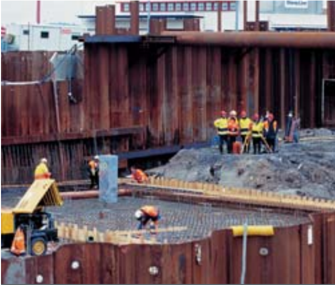
För att stå emot det stora jord- och vattentrycket byggs tunneln vid Järntorget innanför extremt grov stålspont och gjuten tätplatta i botten (höst 2002).
